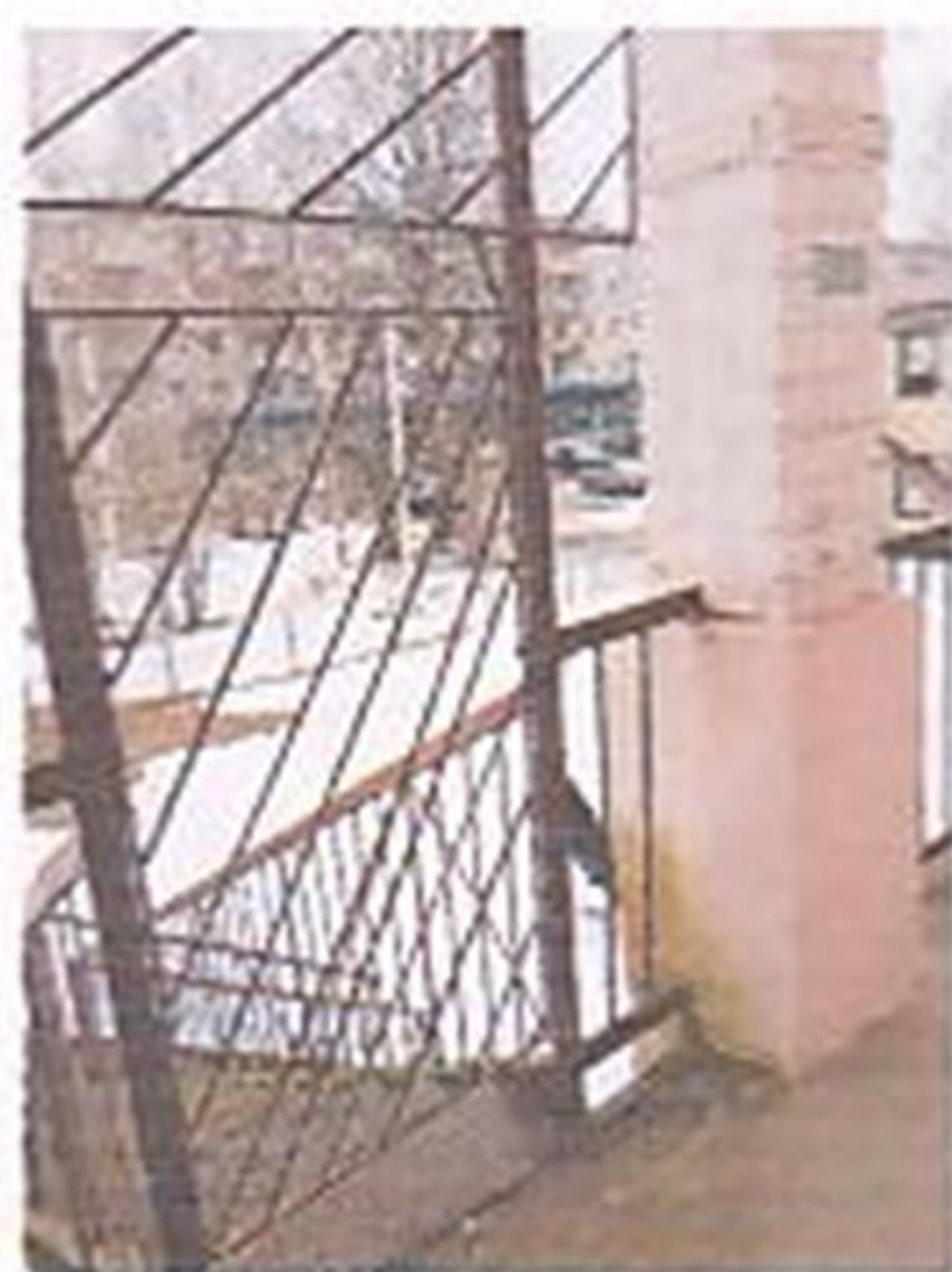
фото 37 - выход по эвакуационной лестнице с балкона 2 этажа
